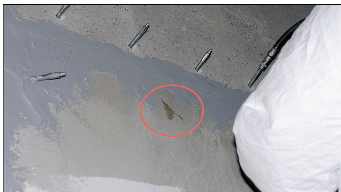
Fot. 3. Typowy „śląd” potwierdzający zakres rozchodzenia się środka iniekcyjnego w murze
