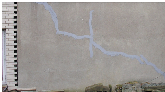
Fot. 1. „Przesklepione” spękanie ściany budynku
